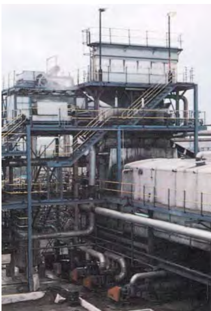
Vista de la alimentación del difusor
